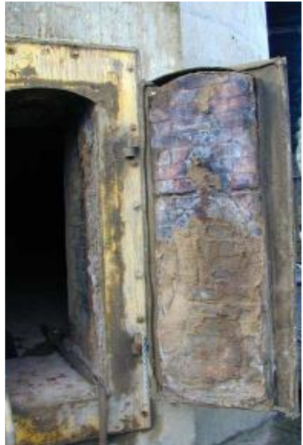
Figura 13 – Selagem com cordão de amianto numa porta de chaminé
