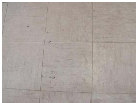
Figura 7 – Revestimento de piso em mosaico contendo amianto
