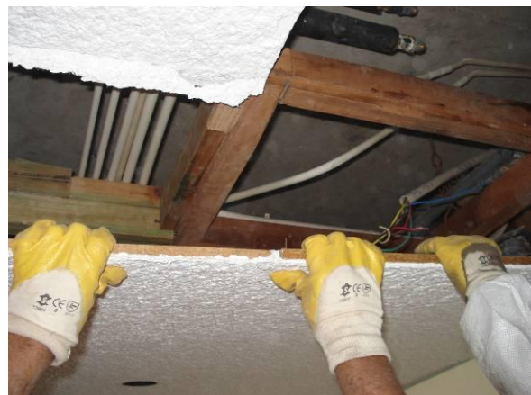
Figura 19 – Placas de tecto falso
