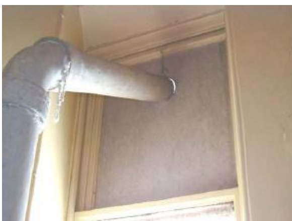
Figura 6 – Conduta em fibrocimento com selantes de junta em cordão de amianto. A conduta atravessa um painel também com amianto
